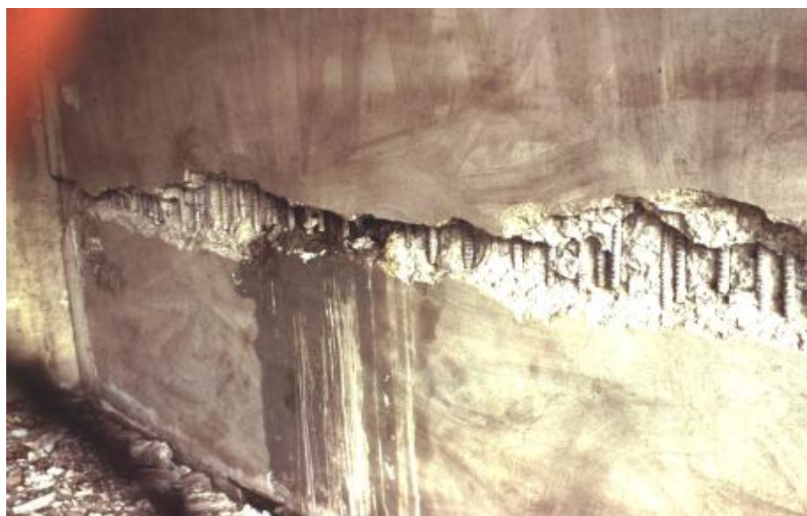
شکل ۴-۱۱۲- ایجاد شکست برشی در کوله در محل وصله آرماتورها. تمام آرماتورها در یک موقعیت وصله شده‌اند- زلزله کوبه (۱۹۹۵) [۶۴].
