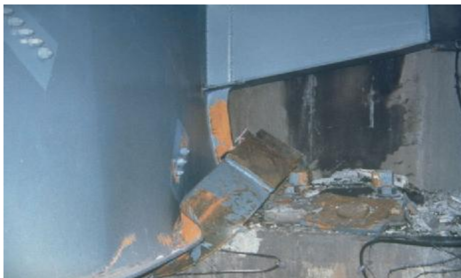
شکل ۴-۲۹- تخریب تکیه‌گاه فلزی که در زلزله کوبه منجر به جابجایی و له‌شدگی شاه‌تیر فولادی در محل تکیه‌گاه شده است [۶۴].
