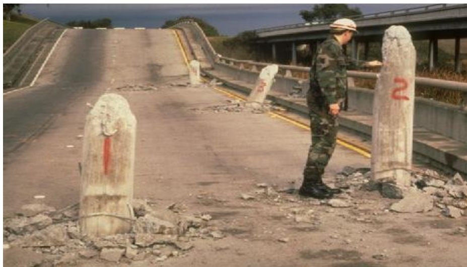
شکل ۴-۸- برش سوراخ‌کننده ستون‌ها در زلزله Loma Prieta منجر به آسیب‌دیدگی روسازه شده است (کوبه) [۶۴].
