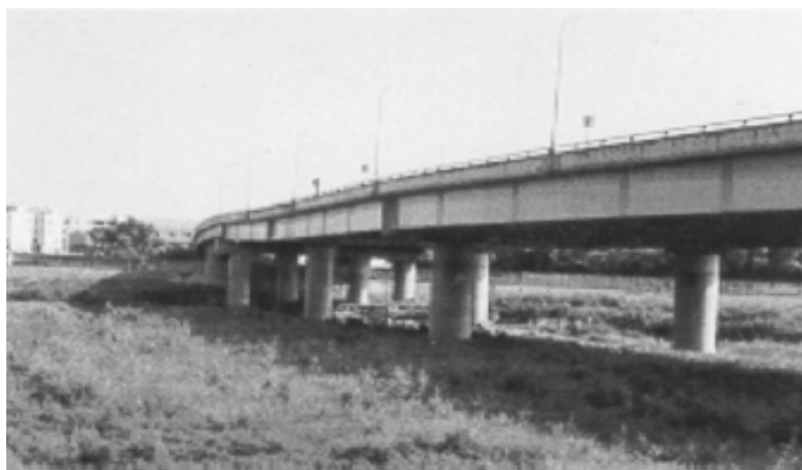
شکل ۴-۹۹- نشست قابل ملاحظه فونداسیون Mao-Luo-Shi Bridge در زلزله Chi Chi (۱۹۹۹) [۵۸].
