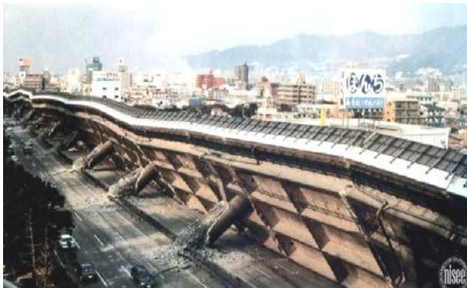
شکل ۴-۱۰۵- نمای دیگر از پل Fukae و خروج کامل پل از بهره‌برداری و نمایش ضعف پایه‌های تک ستون [۷۴].
