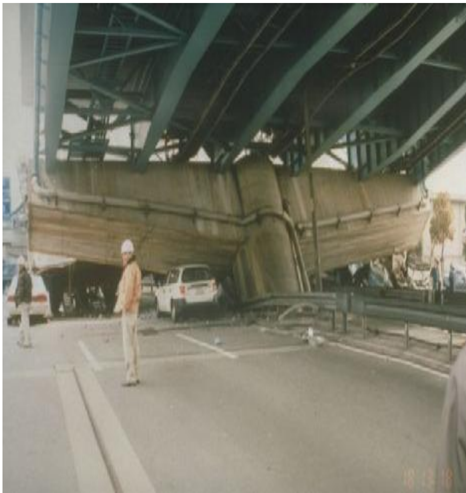
شکل ۴-۳۷- تخریب کامل و غیرشکل‌پذیر زیرسازه بتن مسلح نگهدارنده روسازه فولادی در پل Takashio کوبه بر اثر عدم رعایت ضوابط شکل‌پذیری [۶۳].
