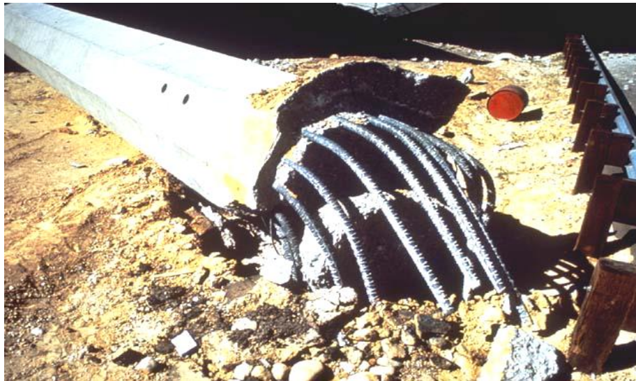
شکل ۴-۶۴- بیرون آمدگی آرماتورها از داخل فونداسیون شمعی پلی در تقاطع I-210/I-5 طی زلزله SanFernando (۱۹۹۷) - این بیرون آمدگی منجر به فروریزش پل گردید [۷۴].
