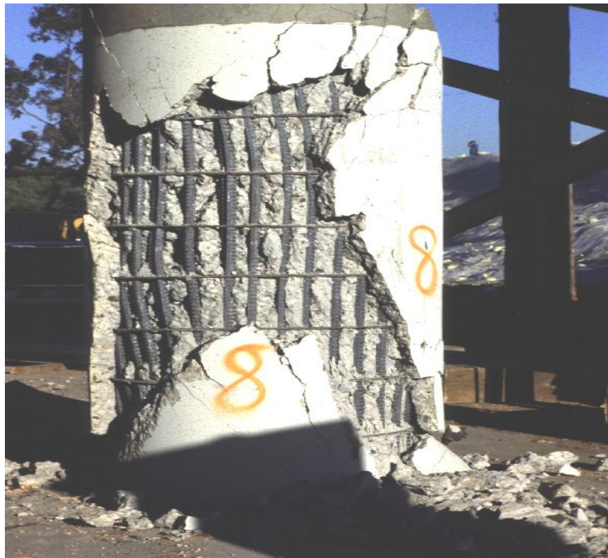
شکل ۴-۳۶- خرد شدن پوشش بتنی پایه پل تقاطع I10 در نورتریج به علت ضعف خاموت‌ها و عدم توانایی در ایجاد محصورشدگی بتن [۵۳].
