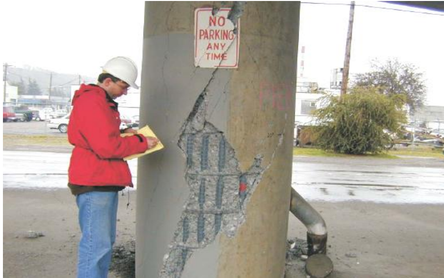
شکل ۴-۴۴- ضعف در مقاومت برشی و پکیدن پوشش بتنی- زلزله Nisqually (۲۰۰۱) [۶۰].
