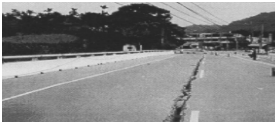
شکل ۴-۵- آسیب وارده به صورت ایجاد یک ترک طولی میان قسمت‌های قدیمی و جدید پل Yang-Ping طی زلزله Chi Chi (۱۹۹۹) [۵۸].
