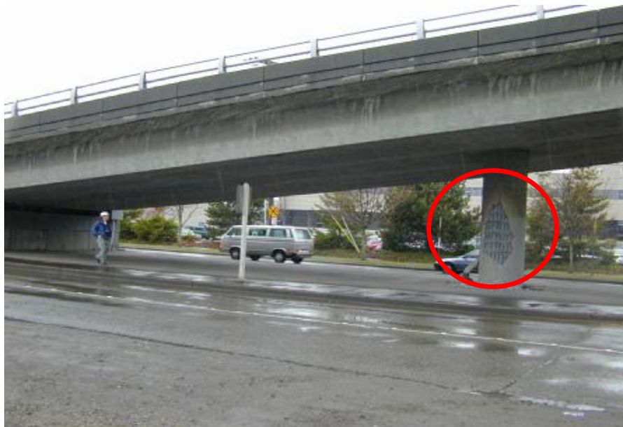
شکل ۴-۴۵- آسیب وارده به پایه تک‌ستون بتن مسلح- زلزله Nisqually (۲۰۰۱) [۶۰].
