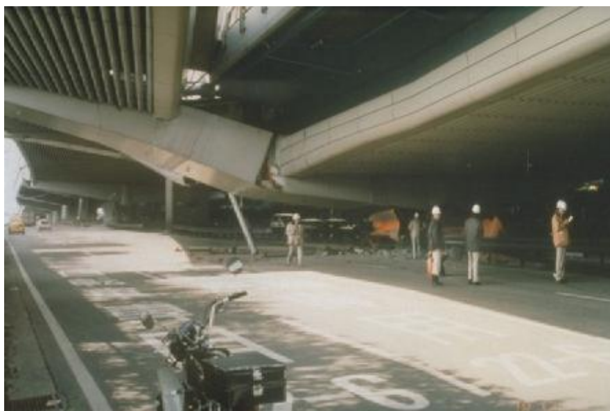
شکل ۴-۶۶- وقوع شکست کلی در ستون جعبه‌ای فولادی - کوبه [۶۳].
