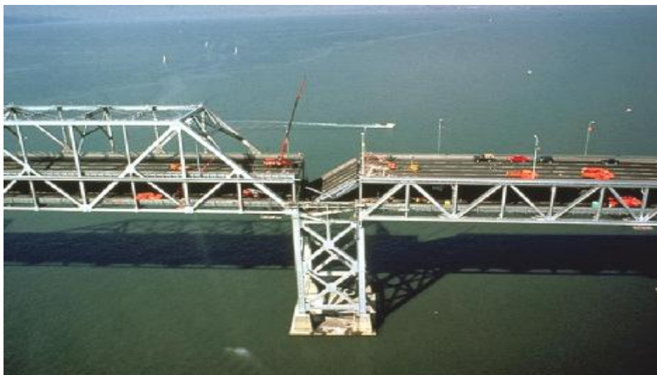
شکل ۴-۲۲- فروافتادگی عرشه پل خلیج Oakland در سانفرانسیسکو در زلزله LomaPrieta (۱۹۸۹) [۵۲].
