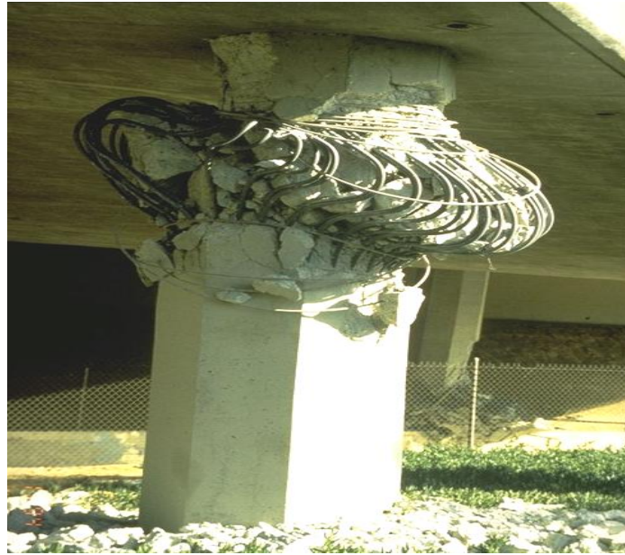
شکل ۴-۶۲- یکی از ستون‌های پل Bull Creek پس از زمین‌لرزه Northridge- تجاوز تقاضای نیروی محوری ستون از ظرفیت و کمبود شکل‌پذیری موجب آسیب شده است [۶۳].
