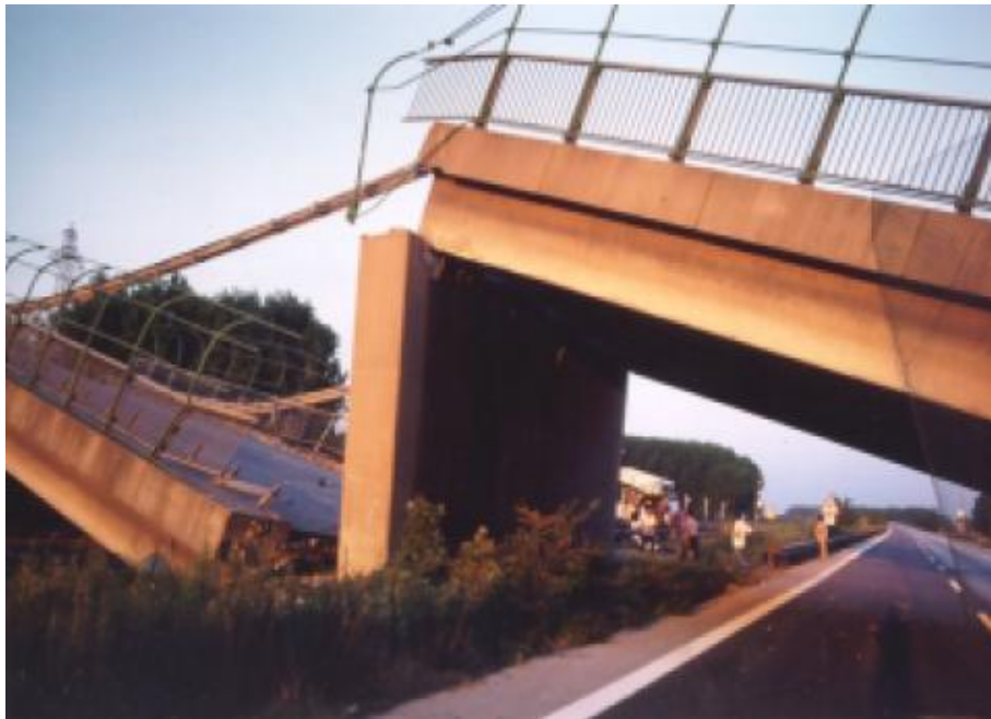
شکل ۴-۱۰۲- فروافتادگی دهانه پل عارفیه در زلزله Kokaeli ۱۹۹۹ ترکیه به علت عبور گسل از ساختگاه [۶۱].
