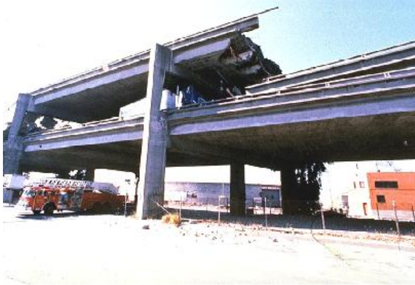
شکل ۴-۸۳- فروریزش فاجعه آمیز پل Cypress در زمین‌لرزه Loma Prieta [۵۲].
