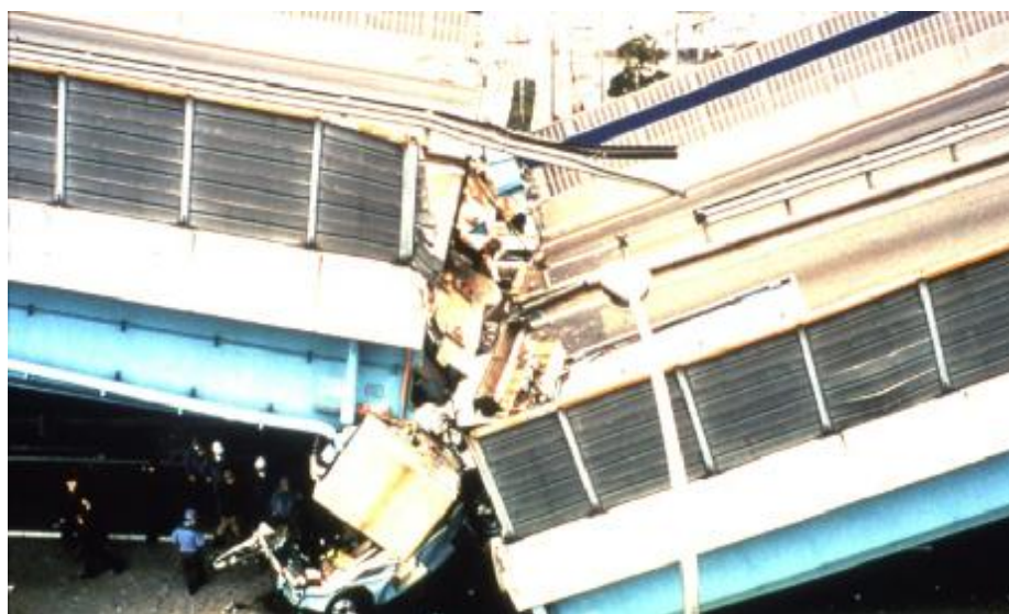
شکل ۴-۷- آسیب وارد شده به روسازه به عنوان آسیب ثانویه در زلزله هانشین (کوبه) [۵۴].
