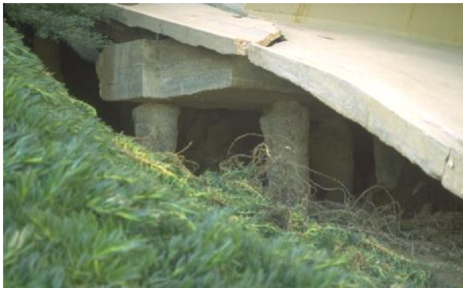
شکل ۴-۱۱۳- تخریب کوله به علت روانگرایی - زلزله Northridge (۱۹۹۴) [۶۴].
