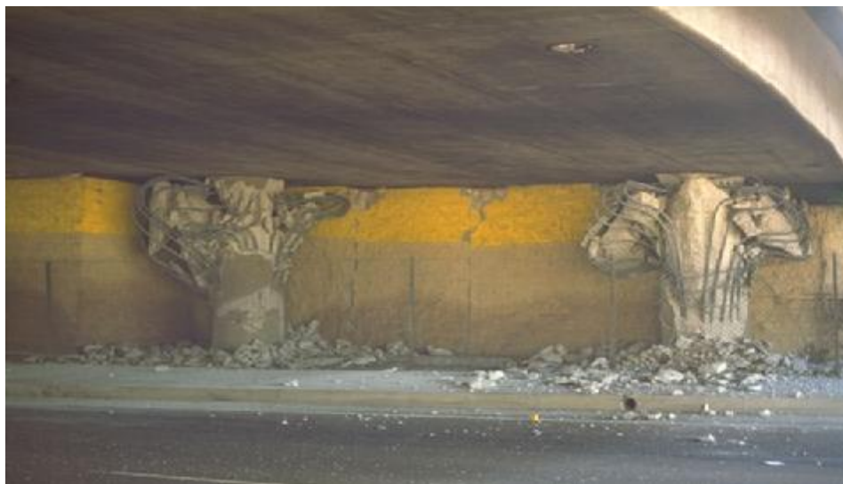
شکل ۴-۴۰- فواصل زیاد آرماتورهای برشی و عدم کفایت در محصورشدگی بتن موجب کماتش آرماتورهای طولی شده است (زلزله Northridge) [۵۳].
