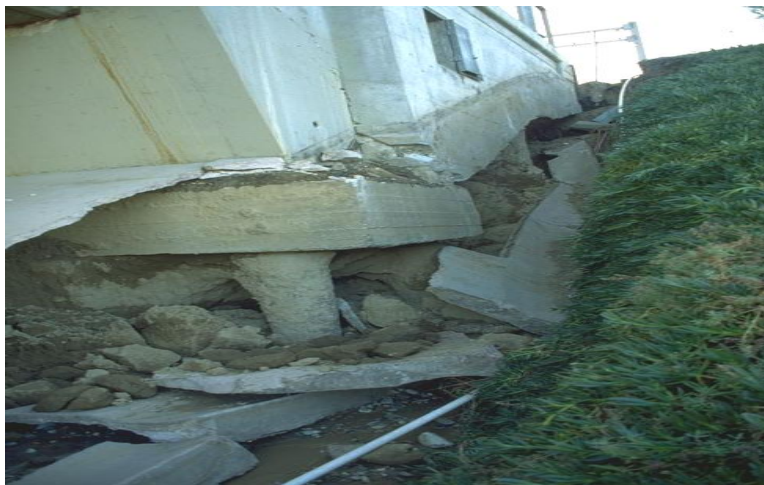
شکل ۴-۱۱۰- آسیب وارده به کوله یکی از پلهای بزرگراهی San Fernando در زمین‌لرزه Northridge (۱۹۹۴) [۵۳].
