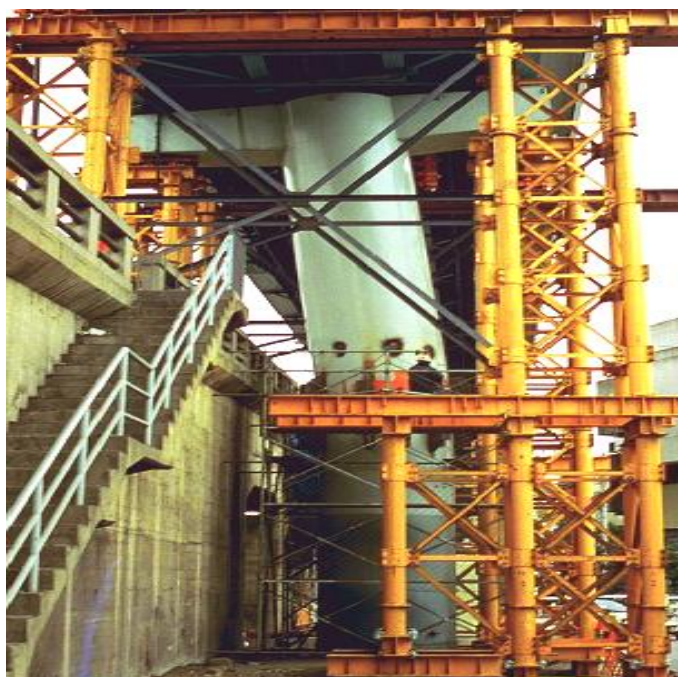
شکل ۴-۷۵- وقوع کماتش موضعی پایه تک‌ستون جدار نازک فولادی - کوبه [۵۴]
