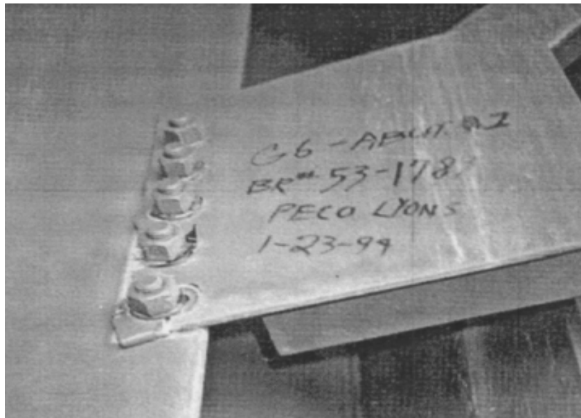
شکل ۴-۲- آسیب وارده به دیافراگم‌های عرضی انتهایی- زلزله Northridge [۶۶]
