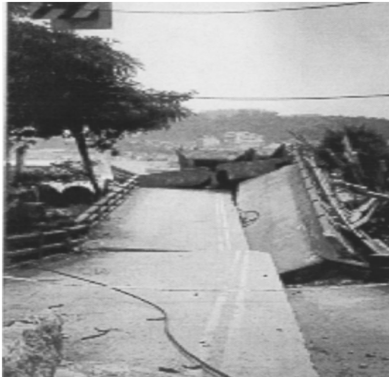
شکل ۴-۱۶- آسیب وارده به پل I-Chang در زلزله Chi Chi (تایوان) [۵۸].
