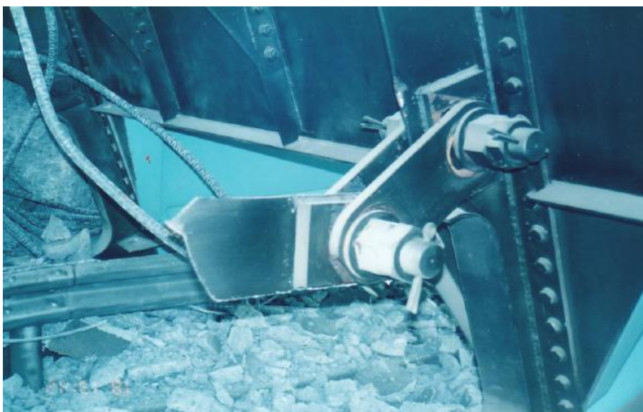
شکل ۴-۹۰- آسیب دیدگی مقیدکننده‌ها- زلزله کوبه [۶۱].
