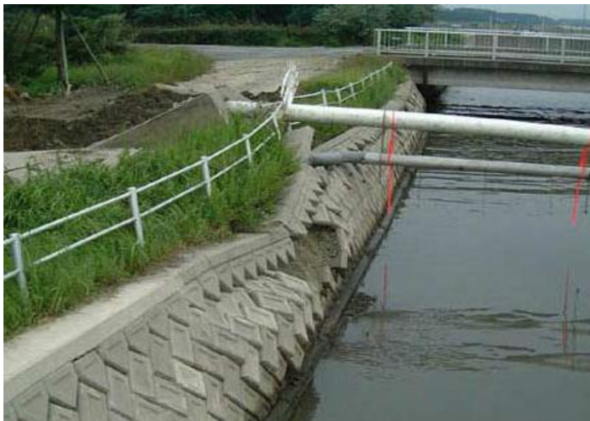
شکل ۴-۱۲۷- آسیب‌دیدگی لوله‌های تأسیسات بر اثر زلزله
