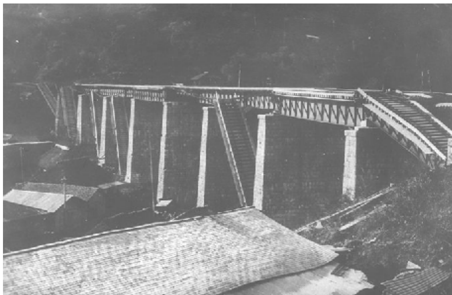
شکل ۴-۲۴- آسیب دیدگی پل راه آهن با دو مسیر عبور طی زلزله Kanto (۱۹۲۳) [۶۴].
