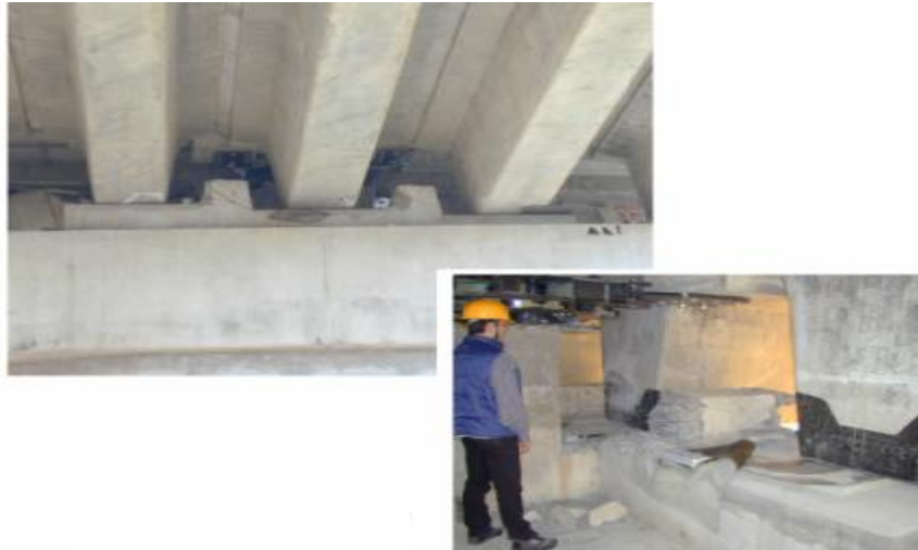
شکل ۴-۹۴- آسیب وارده به کلیدهای برشی داخلی در پل Bolu در زلزله Duzce- ترکیه (۱۹۹۹) [۶۱].
