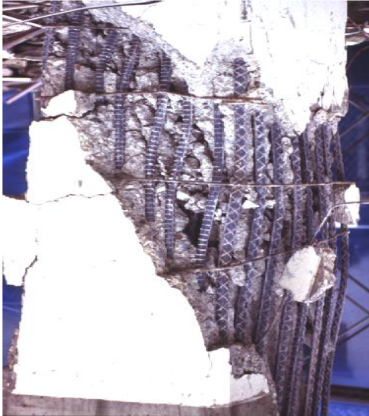
شکل ۴-۶-۴- استفاده از خاموت‌های ضعیف و آرماتورهای طولی در پایه‌های بتن‌آرمه- زلزله Hyogoken-Nanbu [۶۳].
