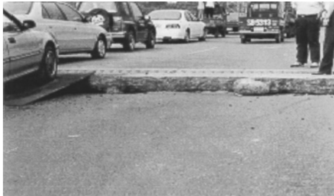
شکل ۴-۱۰۹- نشست خاکریز کوله در پل Shung-Tung در زلزله Chi Chi تایوان (۱۹۹۹) [۵۸].
