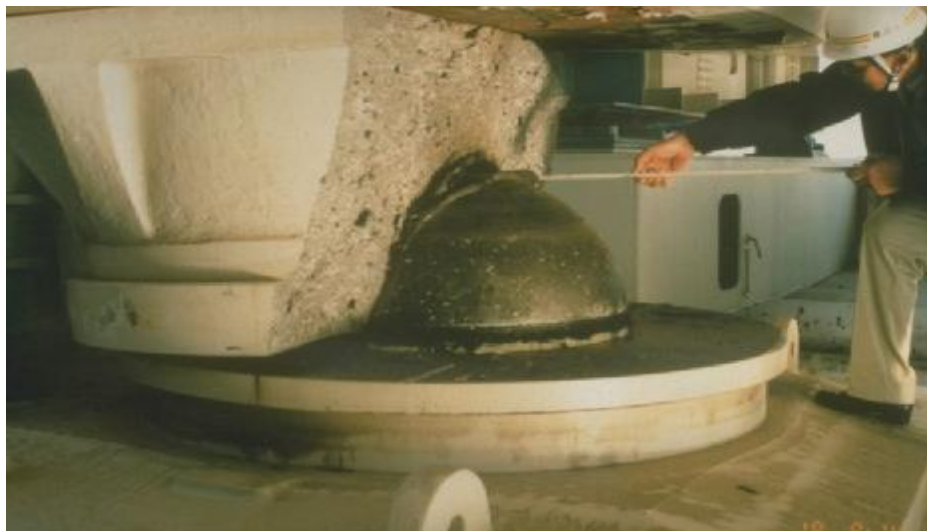
شکل ۴-۲۸- تخریب نشیمن‌گاه پل Nishinomiya-ko در زمین‌لرزه کوبه [۶۴].
