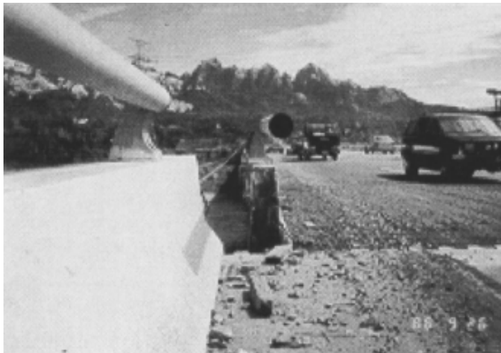
شکل ۴-۹۶- آسیب وارده به کلیدهای برشی در پل Yeng-Feng در زلزله Chi Chi (۱۹۹۹) منجر به جابجایی ناهمگن روسازه شده است [۵۸].
