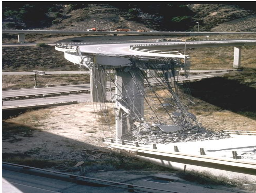
شکل ۴-۱۴- فروافتادگی دهانه به علت عدم کفایت تکیه‌گاه- به جاری شدن میلگردها توجه کنید - Northridge [۶۴].
