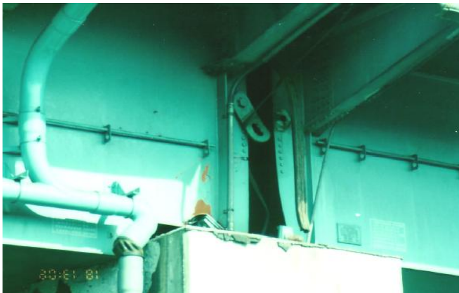
شکل ۴-۸۹- آسیب دیدگی مقیدکننده‌ها- زلزله کوبه [۶۱].
