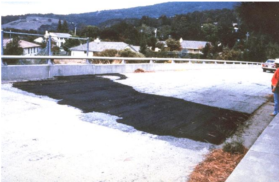
شکل ۴-۱۱۹- آسیب وارده به دال دسترسی و تعمیر آن پس از زلزله Loma Prieta [۵۲].
