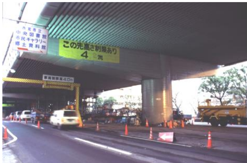
شکل ۴-۸۱- وجود طره‌های بزرگ در پل بزرگراه Hanshin [۵۴]
