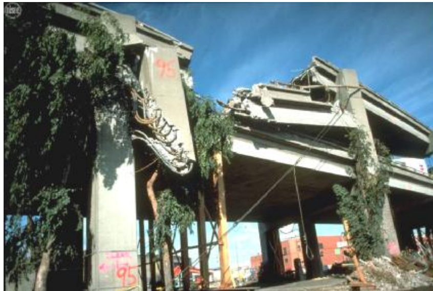
شکل ۴-۸۴- گسیختگی برشی ستون‌ها و شکست اتصالات پل دو طبقه Cypress طی زمین‌لرزه Loma Prieta [۵۲].
