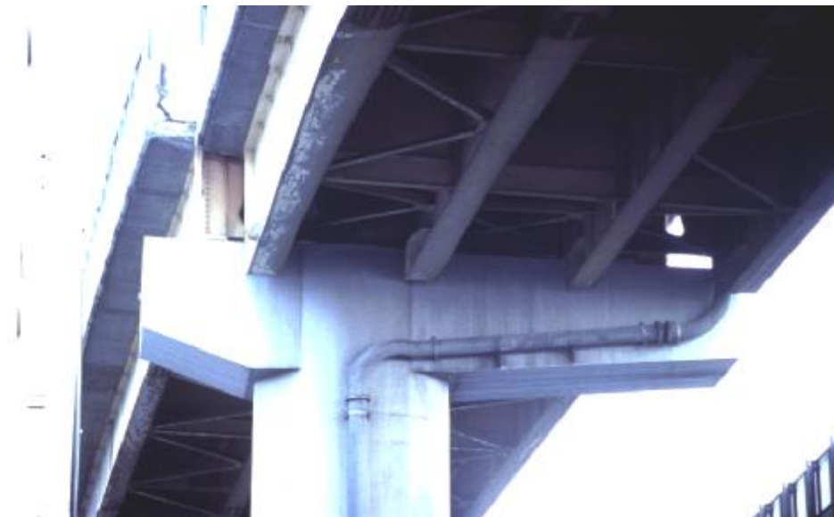
شکل ۴-۲۵- تغییر مکان عرضی زیاد تابلیه روی تکیه‌گاه‌ها- کوبه [۵۴].
