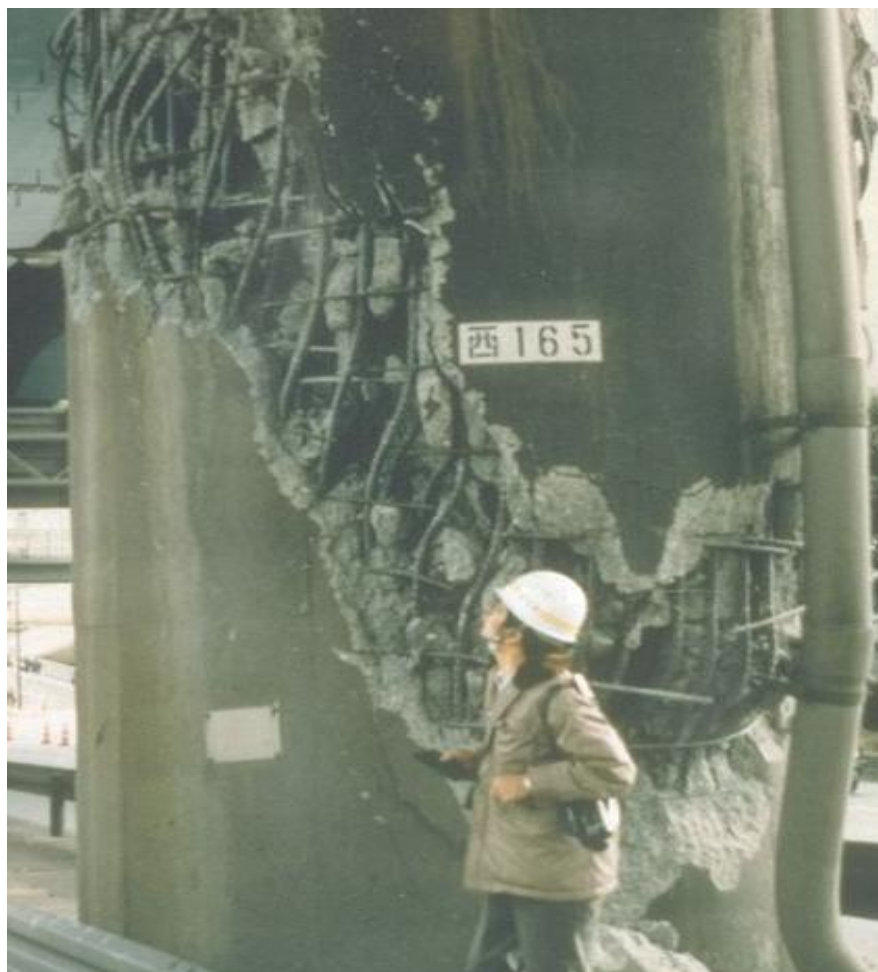
شکل ۴-۴۳- شکست برشی در میانه یکی از پایه‌های بتن مسلح نگهدارنده روسازه فولادی در بزرگراه Hanshin به علت فواصل زیاد آرماتورهای برشی پس از زلزله Hyogoken-Nanbu [۶۳].
