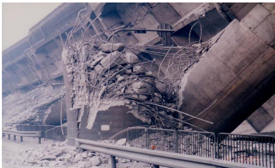
شکل ۴-۶۰- شکست برشی در پل بزرگراه هانشین در کوبه [۶۱].
