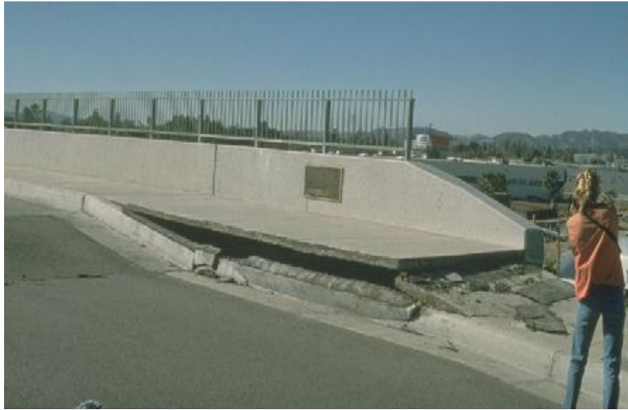
شکل ۴-۱۱۸- آسیب وارده به پیش‌دال به علت نشست کوله، زلزله Northridge [۵۳].
