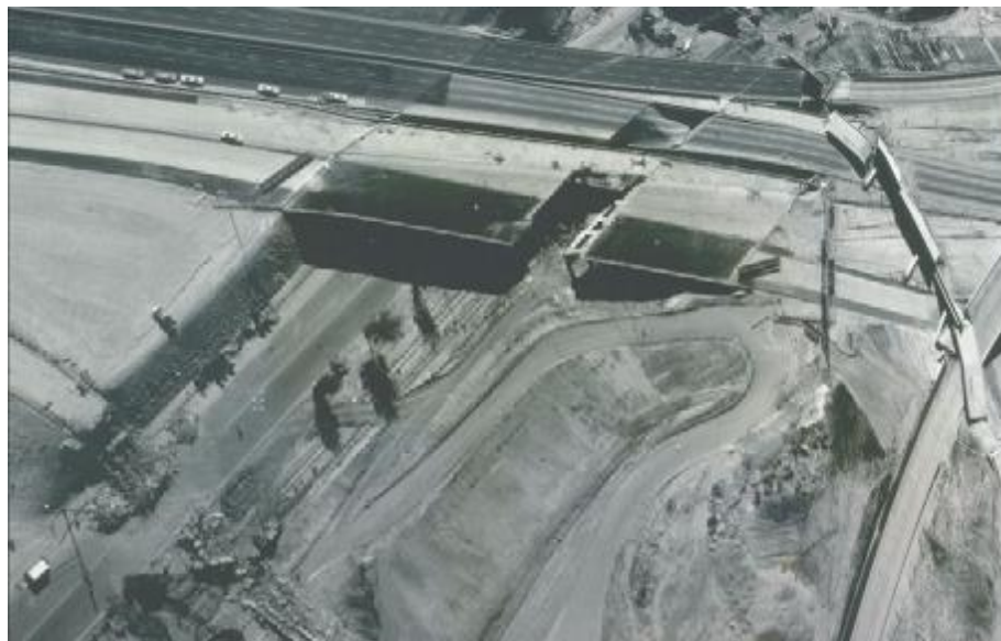
شکل ۴-۶۵- تخریب و مسدود شدن تقاطع I-210/I-5 در کالیفرنیا بر اثر ضعف زیرسازه - زلزله SanFernando (۱۹۷۱) [۷۴].
