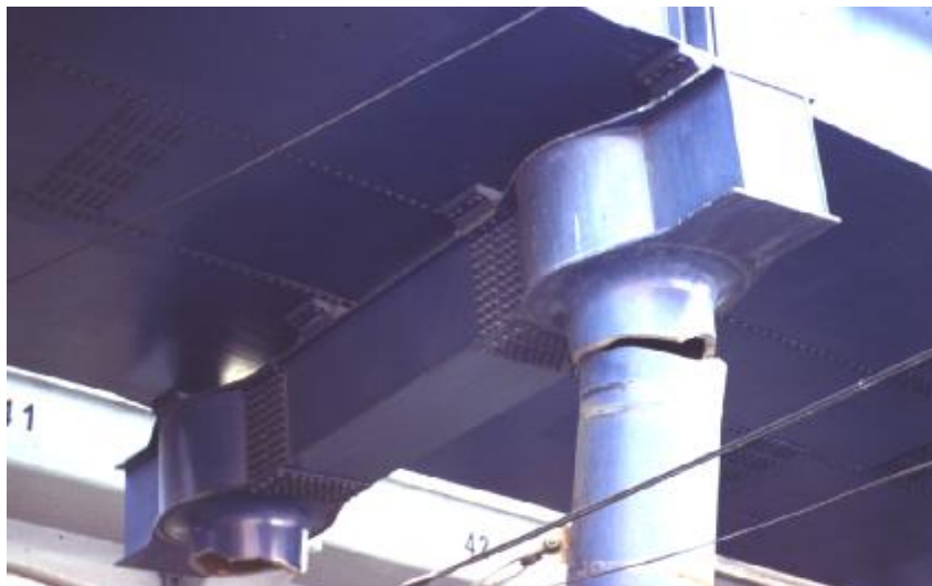
شکل ۴-۷۴- وقوع ترک ترد در یک قاب پرتال یک ستون فولادی ساخته شده با روش گریز از مرکز در ژاپن [۶۴].
