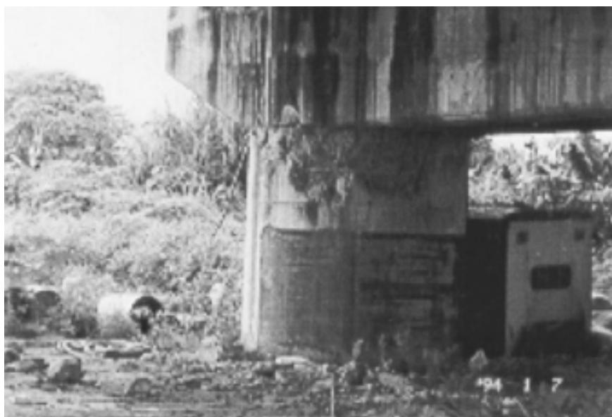
شکل ۴-۴۸- اثر ستون کوتاه در پایه‌های پل Shuong-Tung در زلزله Chi Chi (۱۹۹۹) [۵۸].
