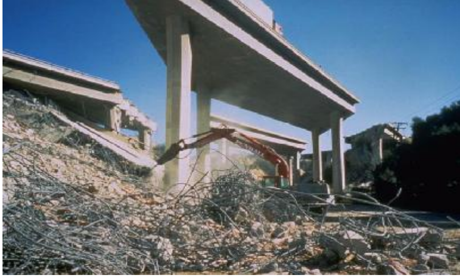
شکل ۴-۹۱- گسیختگی ابزار مقیدکننده عرشه و سقوط دهانه دسترسی پل - زمین‌لرزه Northridge
