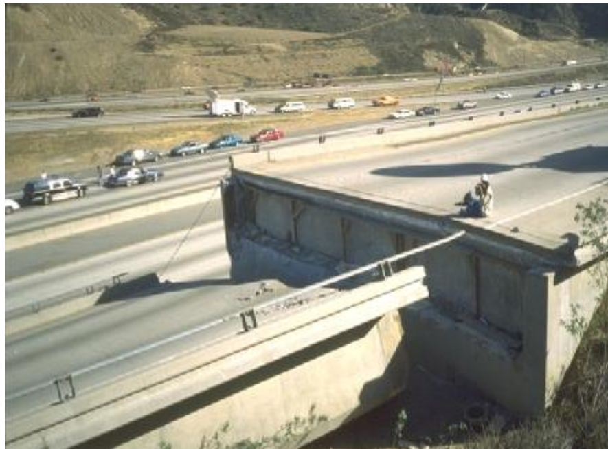
شکل ۴-۱۰۸- عدم کفایت کوله و جداسدگی از روسازه - زلزله Northridge [۵۳].
