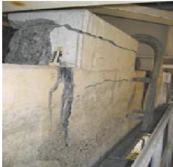
شکل ۴-۹۵- آسیب وارده به کلیدهای برشی در پل Shizukawa در زلزله Tokashi-Oki ژاپن (۲۰۰۳) [۶۸].
