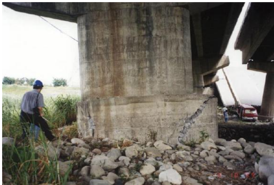
شکل ۴-۹۸- آسیب وارده به فونداسیون از نوع کیسون ناشی از حرکت گسل در پل Wu-Shi طی زمین‌لرزه Chi Chi (۱۹۹۹) [۵۷].
