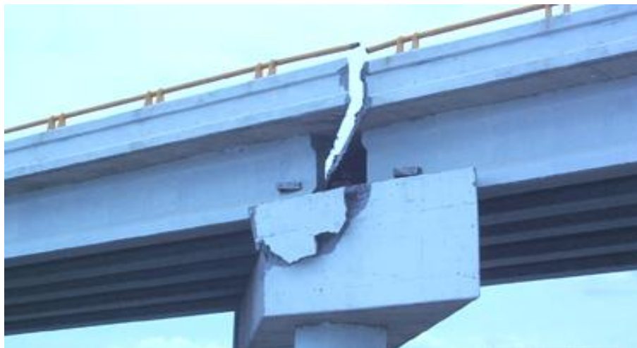
شکل ۴-۱۲۳- آسیب وارده به درز اجرایی و تیر سرستون در پل بزرگراه ۱۳۵ Tehuacán در زلزله تایوان (۱۹۹۹) [۶۴].
