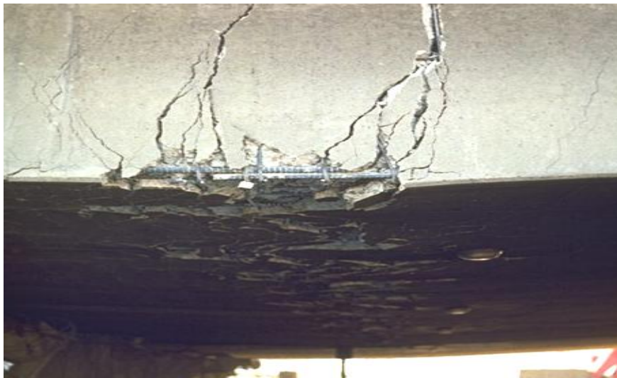
شکل ۴-۱۳- ترک‌های خمشی ایجاد شده در تابلیه ناشی از تخریب پایه‌ها- Northridge [۶۴].
