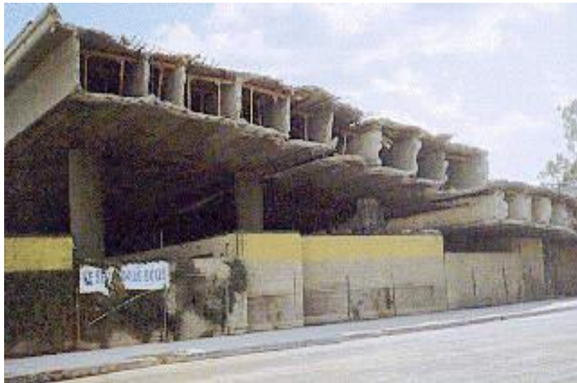
شکل ۴-۱۱- انهدام کامل عرشه در تقاطع I10 کالیفرنیا طی زلزله Northridge [۶۴].
