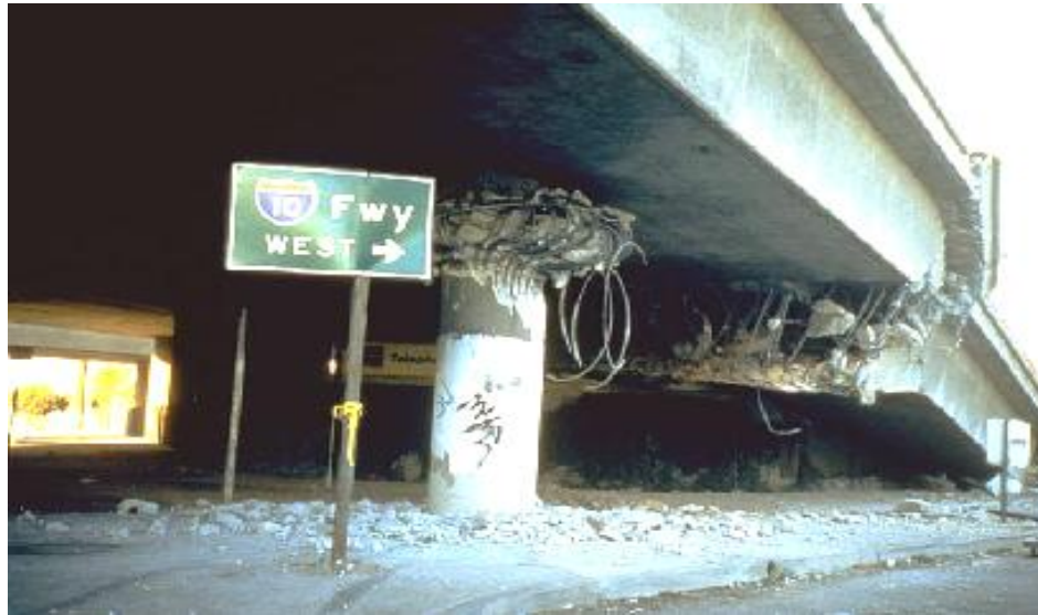
شکل ۴-۳۹ شکل پذیری ناچیز ستون‌ها موجب شد تا پل Santa Monica طی زلزله Northridge دچار آسیب دیدگی شدیدی شود [۵۳].
