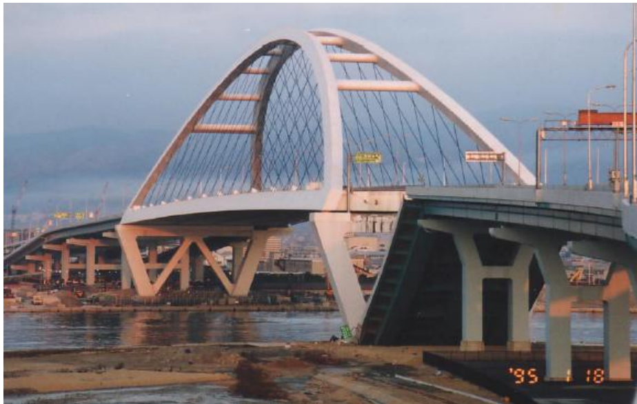
شکل ۴-۹۲- گسیختگی ابزار مقیدکننده عرشه و سقوط دهانه دسترسی پل Nishinomiya در زمین‌لرزه Hyogoken-Nanbu کوبه [۶۱].
