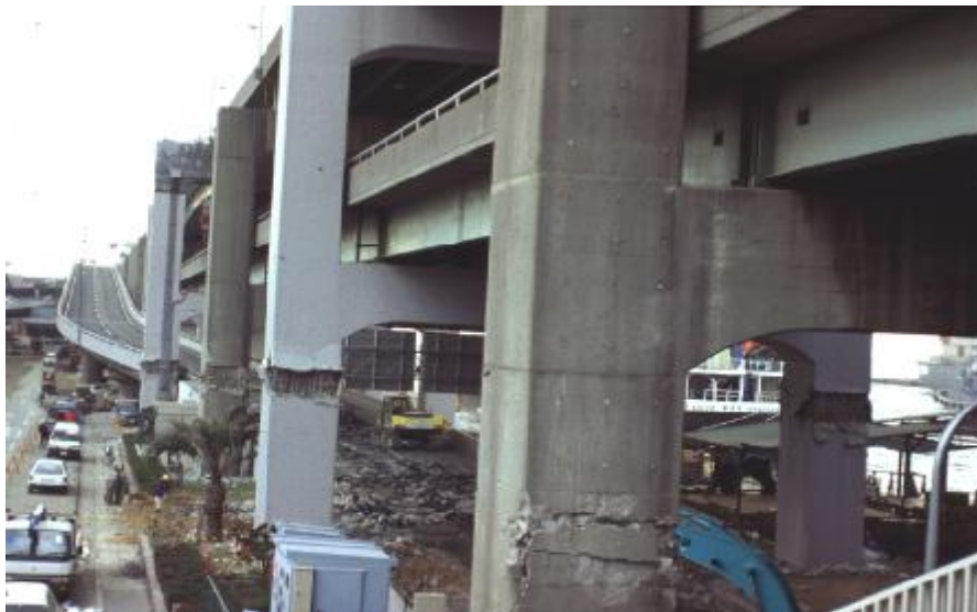
شکل ۴-۶۳- شکست برشی ستون‌های یک پل دو عرشه (کوبه) [۵۴].
