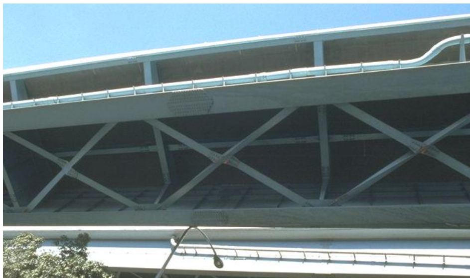
شکل ۴-۶- کمانش مهاربندی‌های روسازه فولادی پایه ۲۰۹ از بزرگراه Hanshin در کوبه [۶۴].
