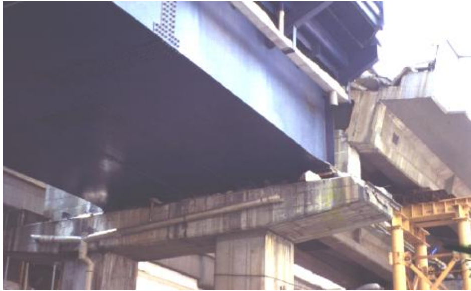
شکل ۴-۸۰- خرابی ایجاد شده بین قسمتهای فولادی و بتنی - کوبه [۵۴]
