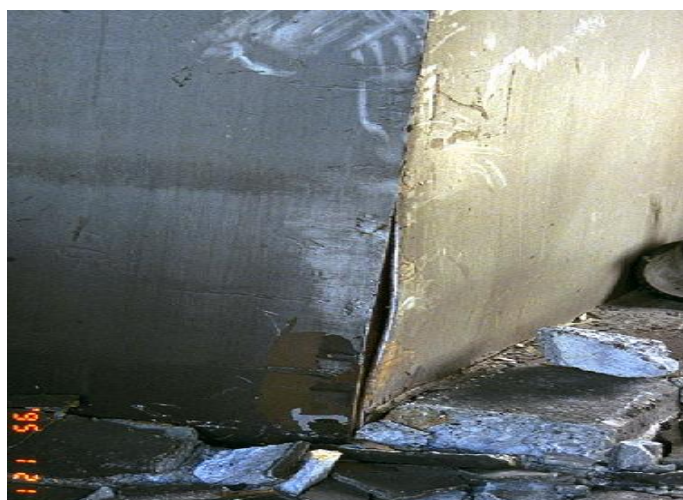
شکل ۴-۶۸- شکست درز جوش در ستون مجاور ستون فروریخته - کوبه [۵۴].
