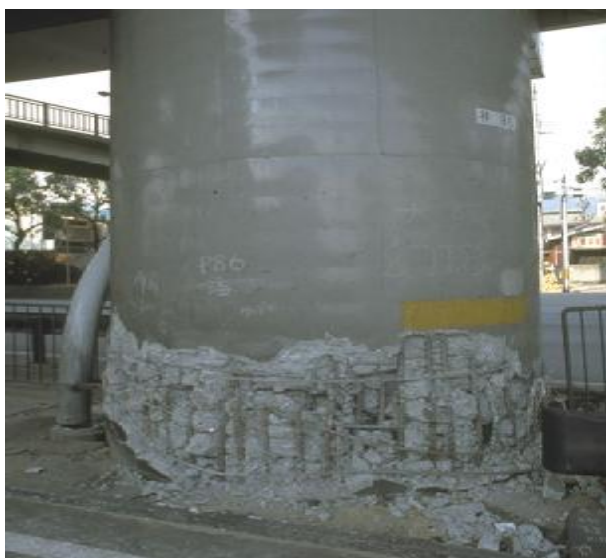
شکل ۴-۶۱- شکست ستون به علت ضعف در محصورشدگی بتن [۶۴].
