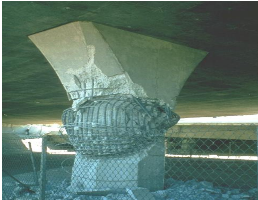
شکل ۴-۵۰- شکست یکی از ستون‌های پل مسیر ۱۱۸ زیرگذر Misson-Gothic در زلزله Northridge [۶۳].
